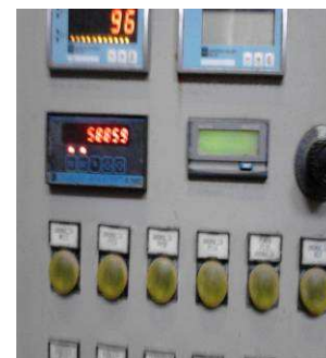
miglioramento 2015 aspirazione ITR- quadro dei nuovi ventilatori
